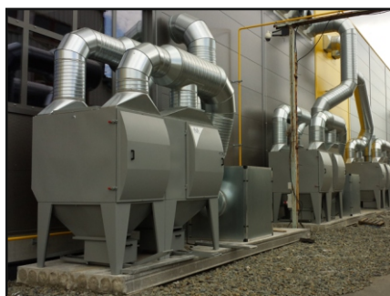
TŘÍDÍČ, Šternberk - odsávání svařovny, pálírny a skladu materiálu systémem TCL. Velikost haly je 160x60 m.
